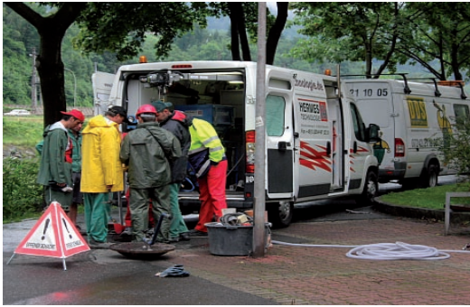
Baustellenbesprechung vor der KS-ASS-Anlage.
